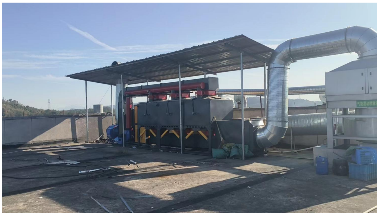
调漆、喷漆、烘干、燃气废气处理设施
