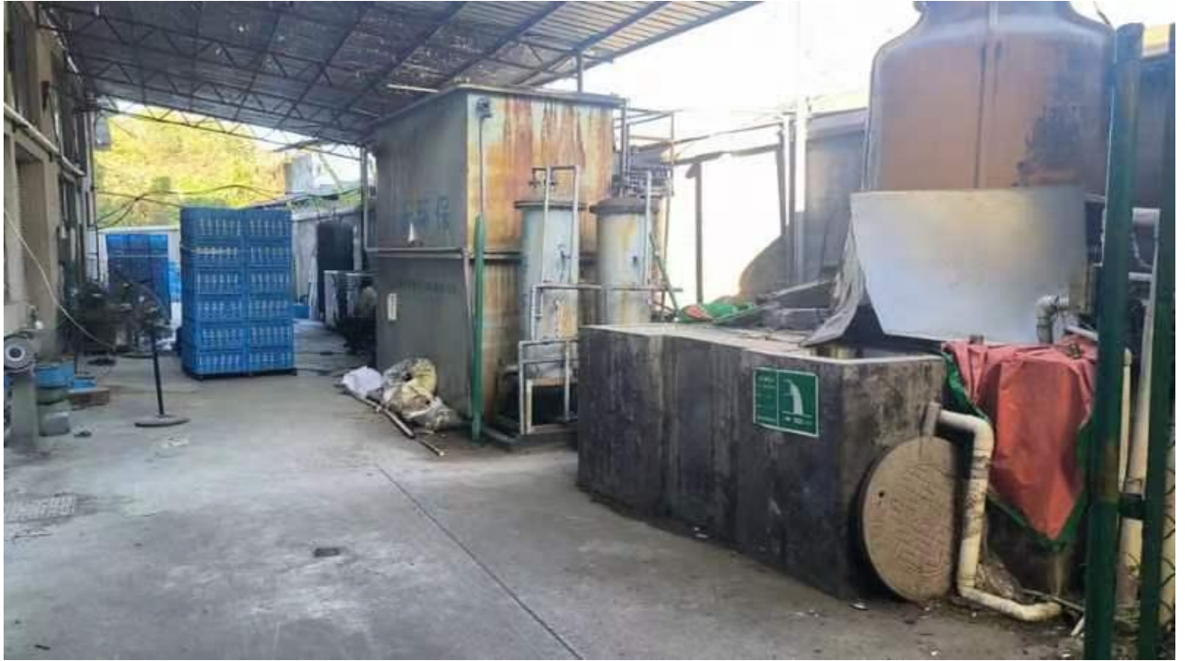
附件6 废水处理设施照片
