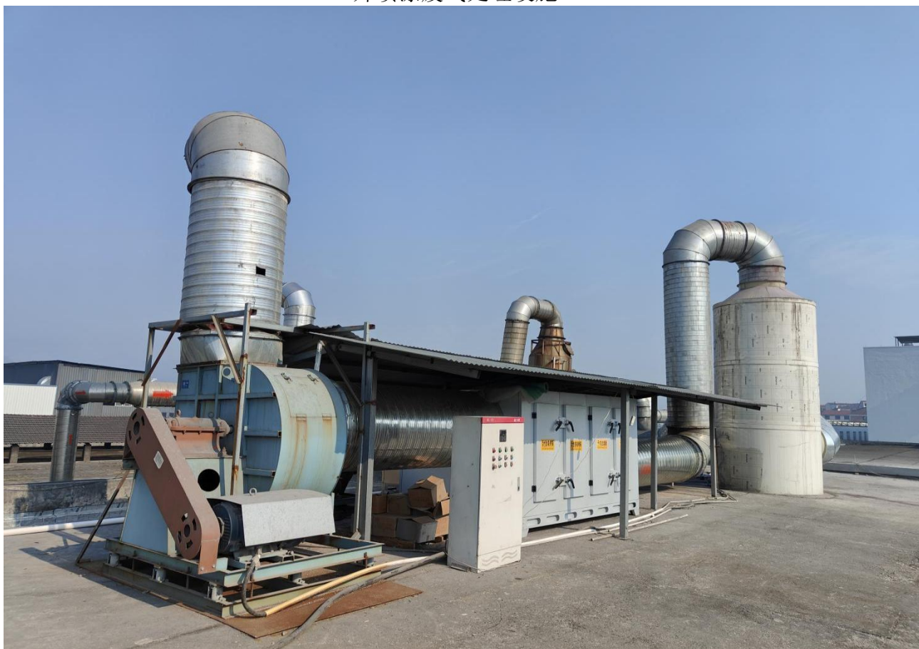
内喷涂废气处理设施
