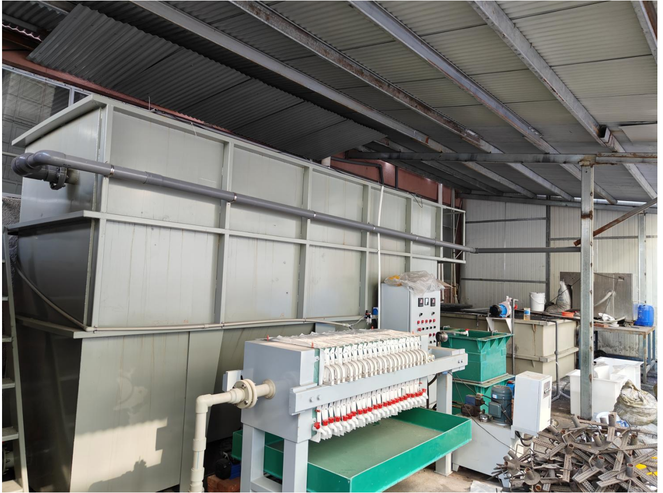
附件 6 废水处理设施照片
