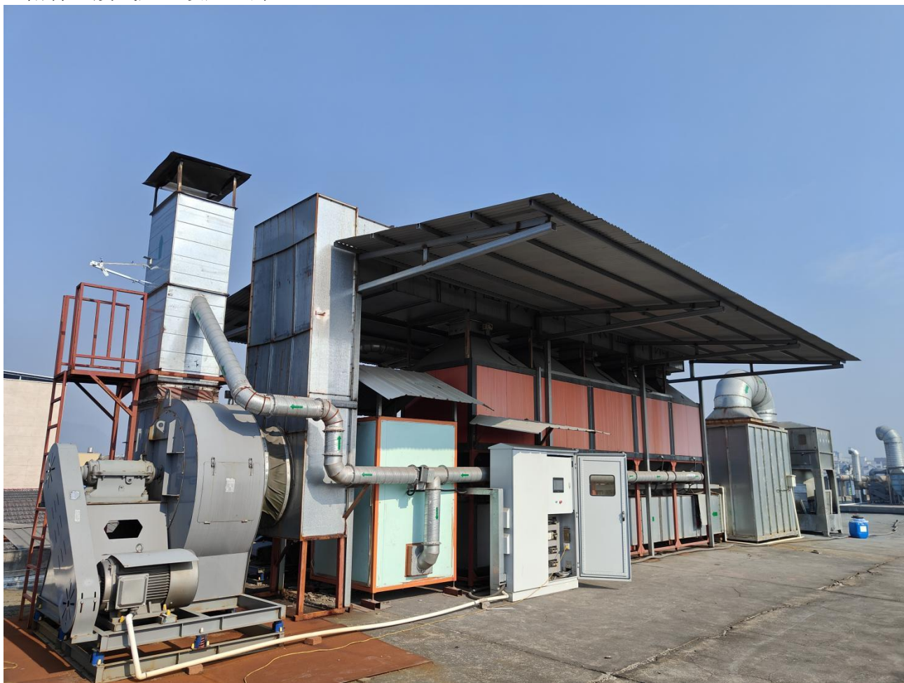
外喷涂废气处理设施
