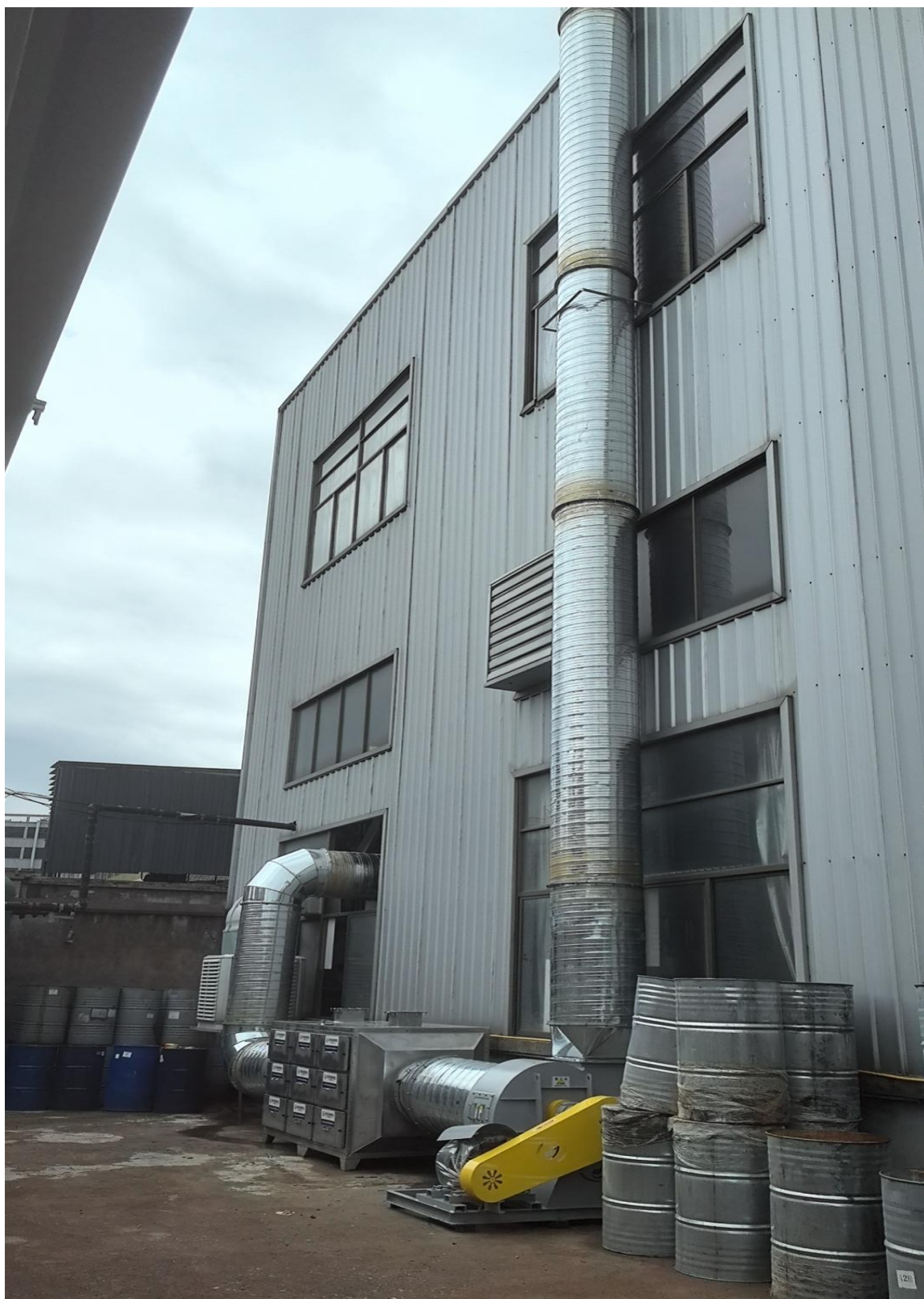
附件7 废气处理设施照片
