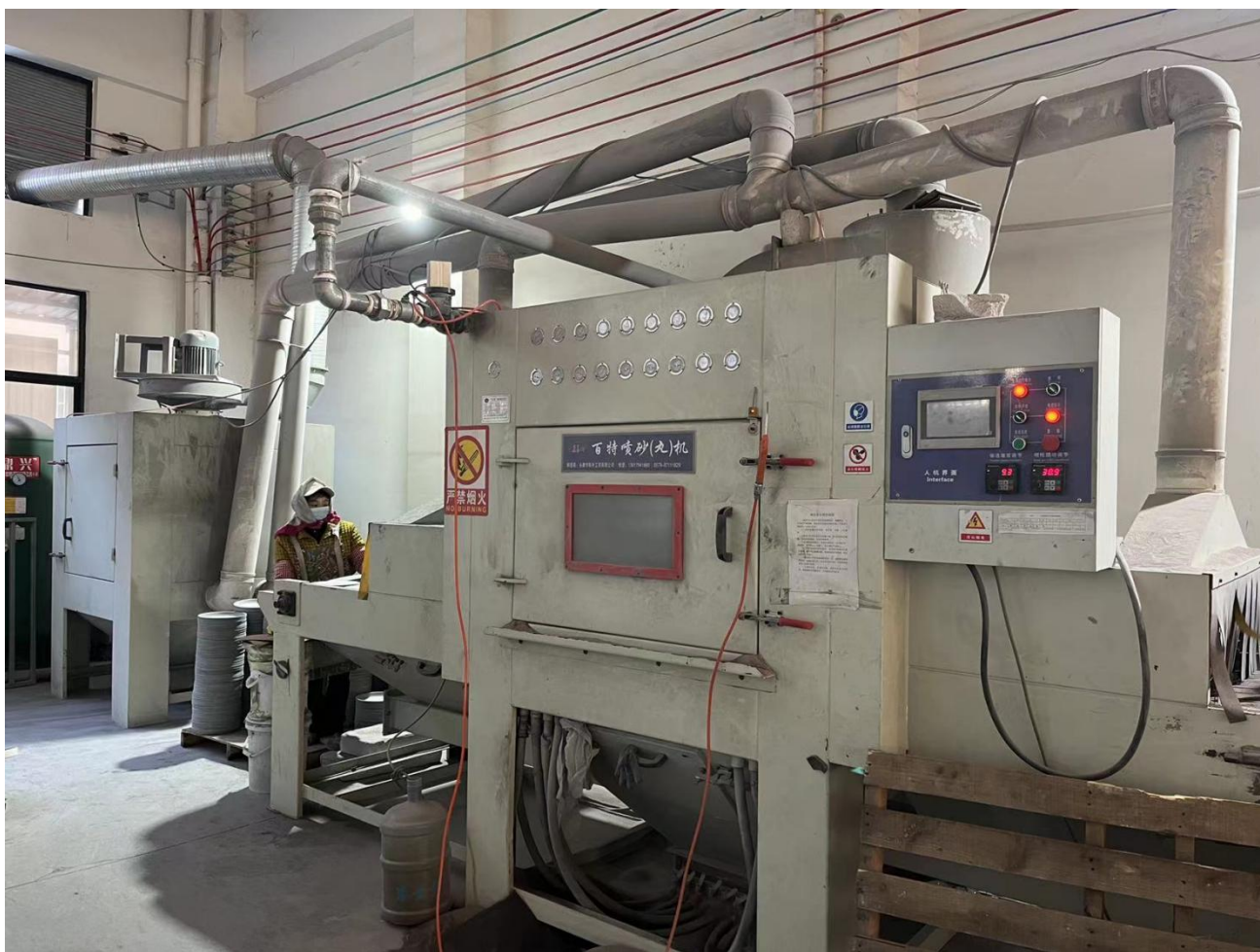
喷砂废气处理设施照片
