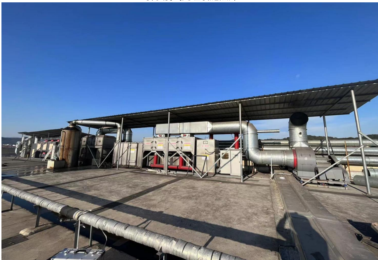
涂装废气处理设施照片
