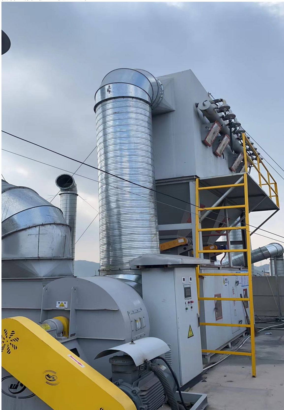
投料、研磨粉尘处理设施
