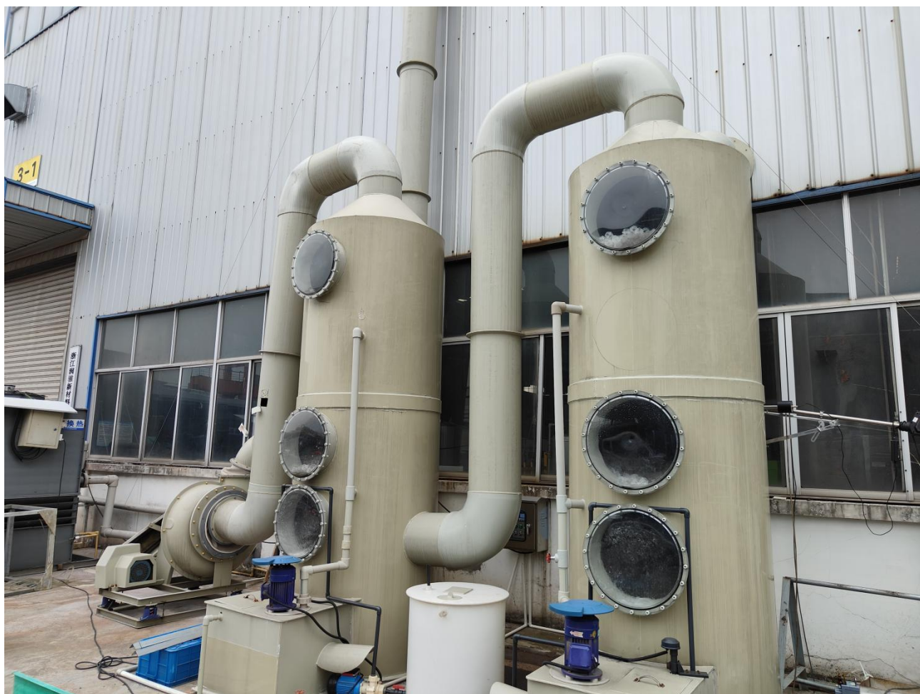
附件 5 废气处理设施照片
