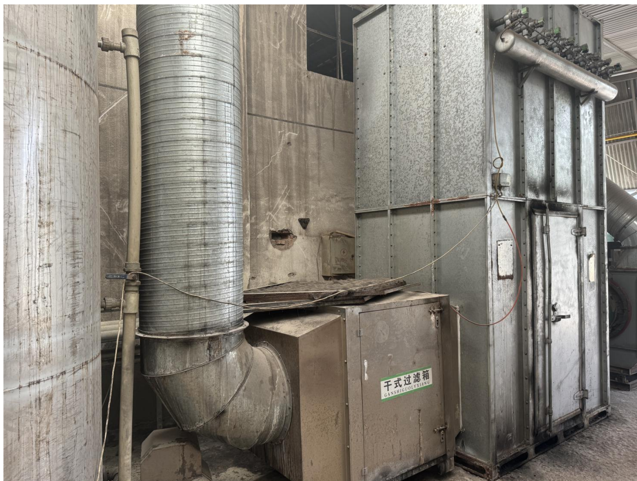
附件7废气处理设施照片
