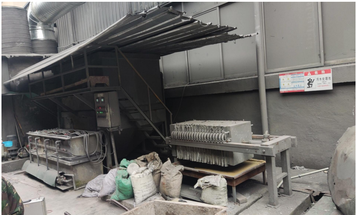
附件 6 废水处理设施照片
