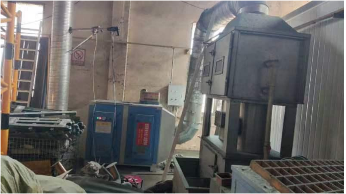
固化废气、天然气燃烧废气处理设施
