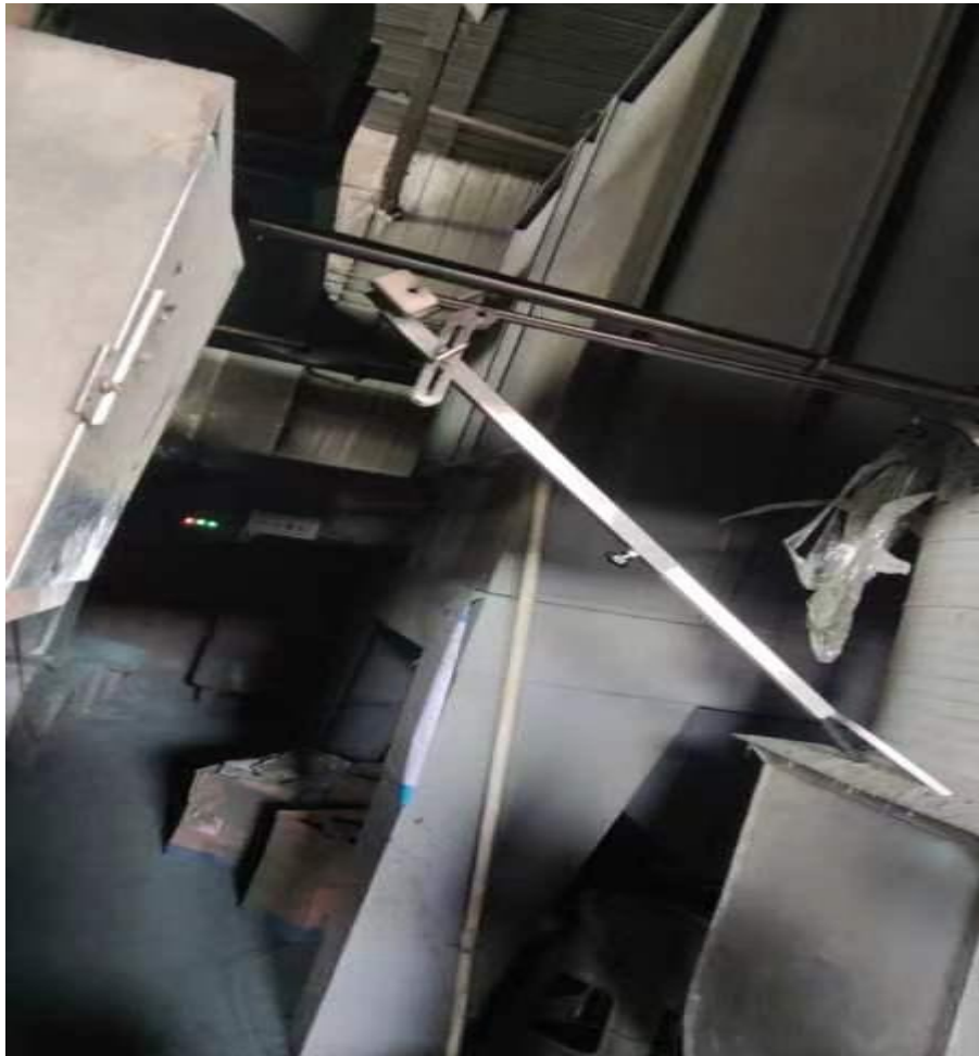
喷塑粉尘处理设施
