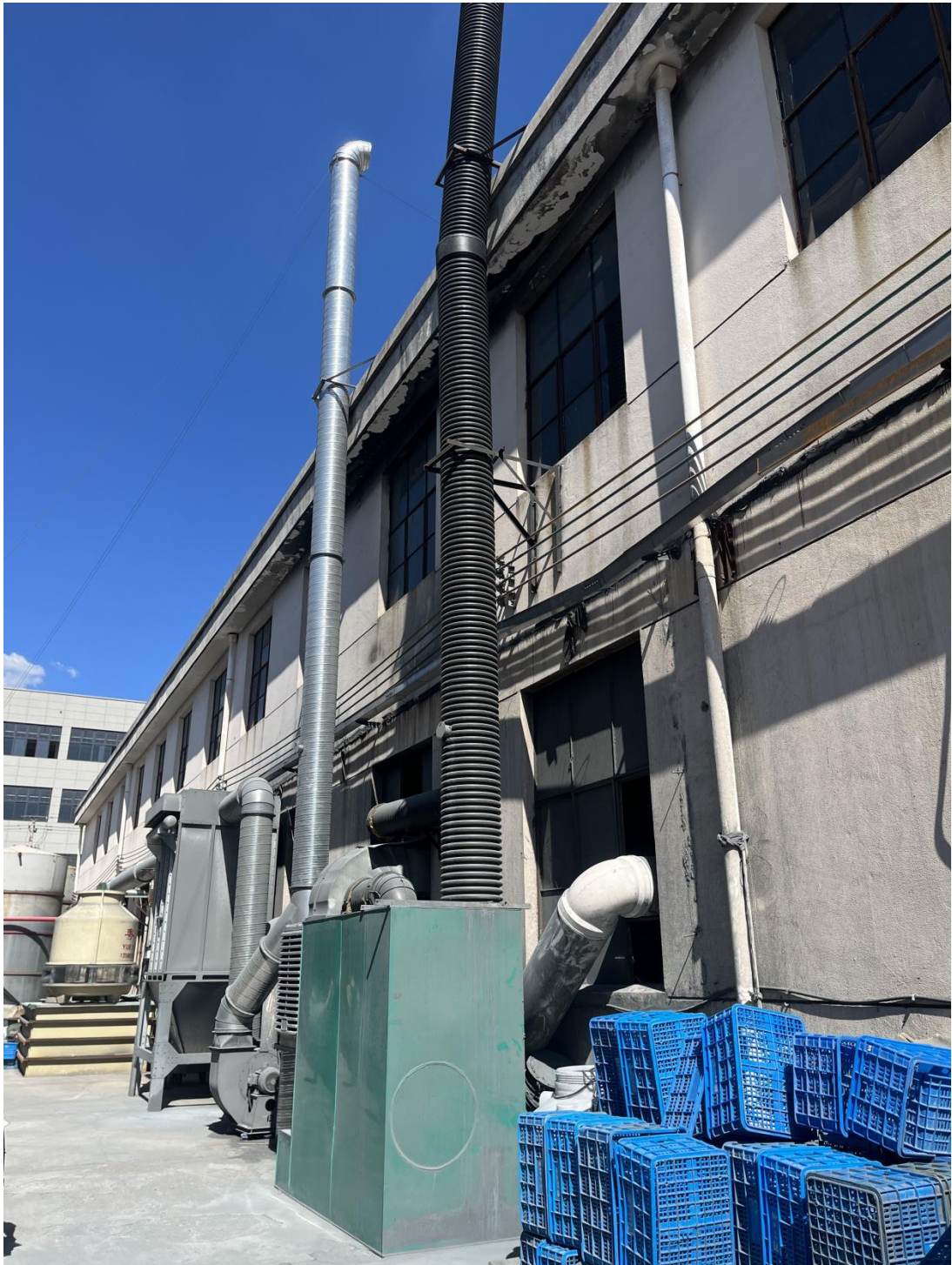
附件6 废气处理设施照片
