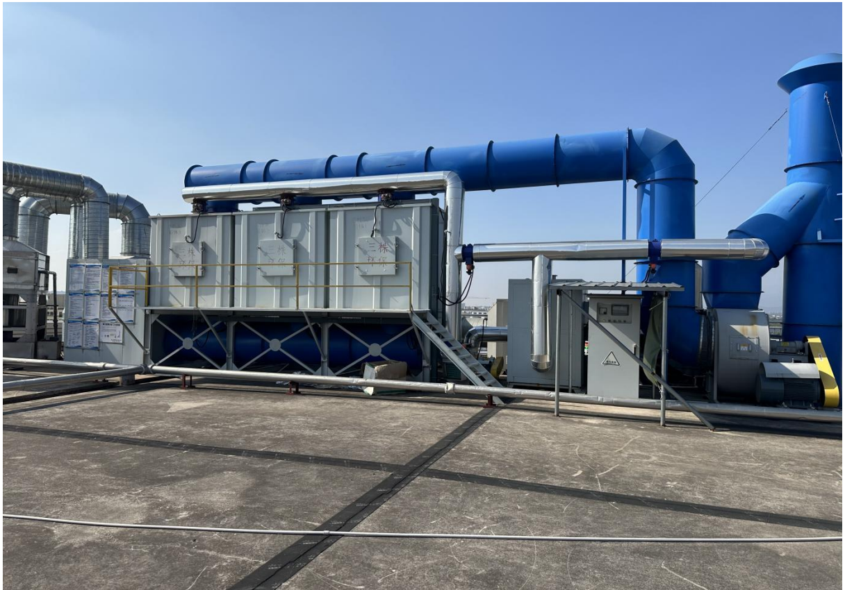
喷漆、浸涂、烘干废气处理设施
