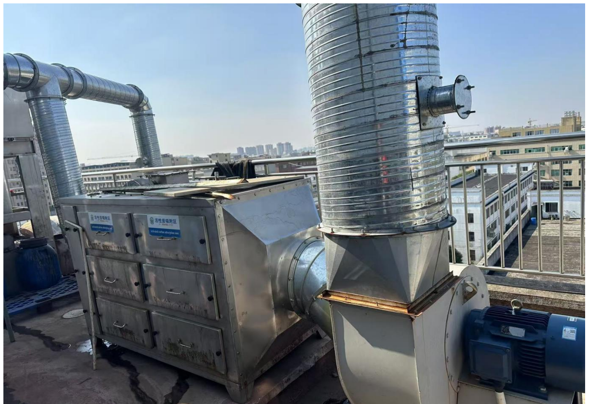
吹塑废气处理设施
