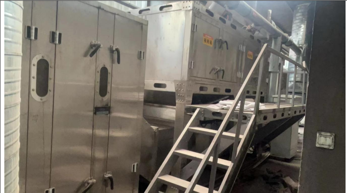
调漆、喷漆、烘干、固化、燃气废气处理设施
